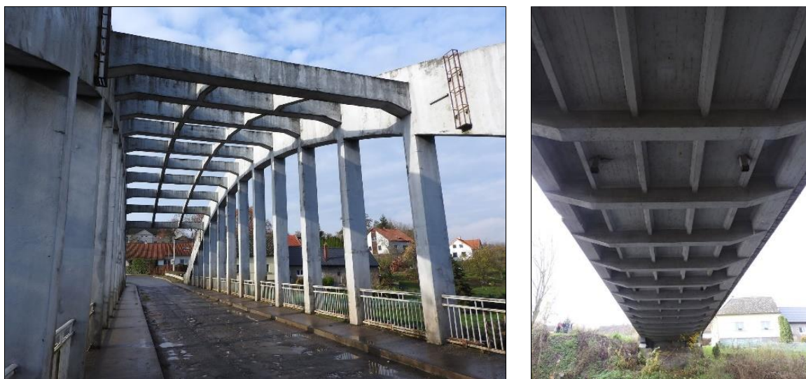
Obr. 57 Oblouk s dolní mostovkou, uložený na ložiskách. Vlevo: pohled na povrch mostu a příčné ztužení nad vozovkou, vozovka a chodníky mezi obloukovými žebry. Vpravo: podhled mostovky (podélná táhla/trámy, mezilehlé podélníky, příčníky v místě závěsů, mostovková deska – pod chodníky zvýšená); Tuřice, 1924, L = 51,510 m
