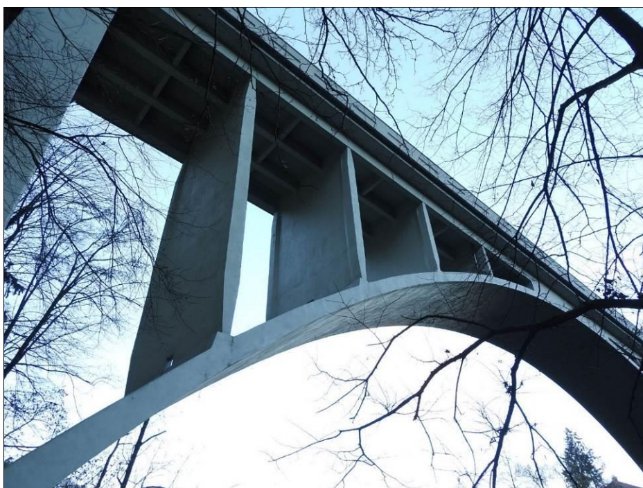
Obr. 36 Roštová mostovka; vzpěry na obou koncích zúžené a opatřené betonovými (vrubovými) klouby; Tábor - Švehlův most, 1935, L = 81,600 m
