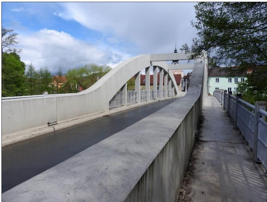
Obr. 50 Příklad zvláštního způsobu uložení u konstrukcí o více polích – trémová krajní pole jsou uložena na ozubu krátké konzoly vyložené z obloukové nosné konstrukce hlavního pole, pohled shora; Staňkov, 1920, L = 33,660 m (viz též Obr. 51 )
