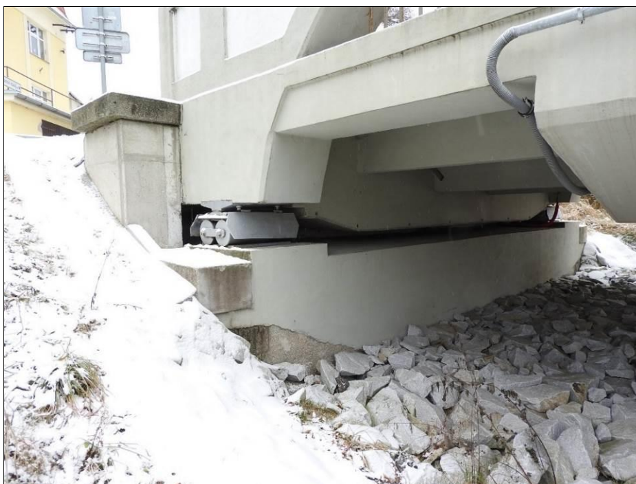
Obr. 39 Oblouk s dolní mostovkou, uložení na ložiska – posuvná ocelová ložiska válcová (na druhé opěře je pevné uložení – viz Obr. 38 ); Horní Vltavice, 1926, L = 27,300 m
