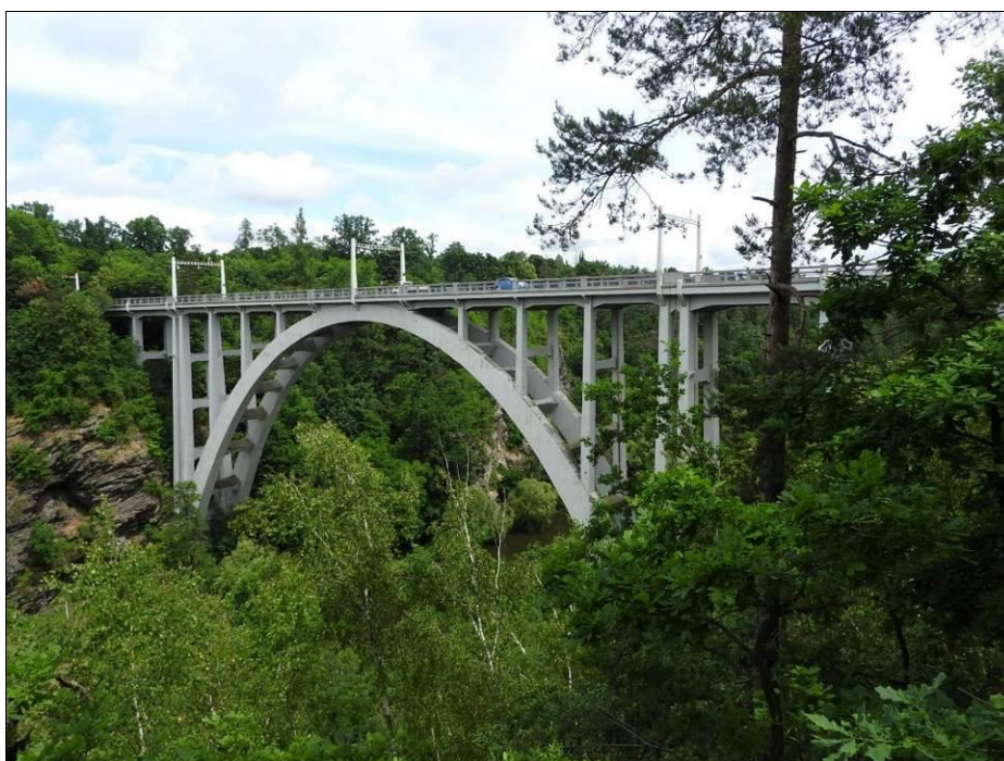
Obr. 32 Členěné vzpěry, vetknuté na horním i na dolním konci; mostovka roštová; příčné dilatační spáry v mostovce u vrcholu oblouku a nad patkami oblouku; Bechyně, 1928, L = 90,000 m
