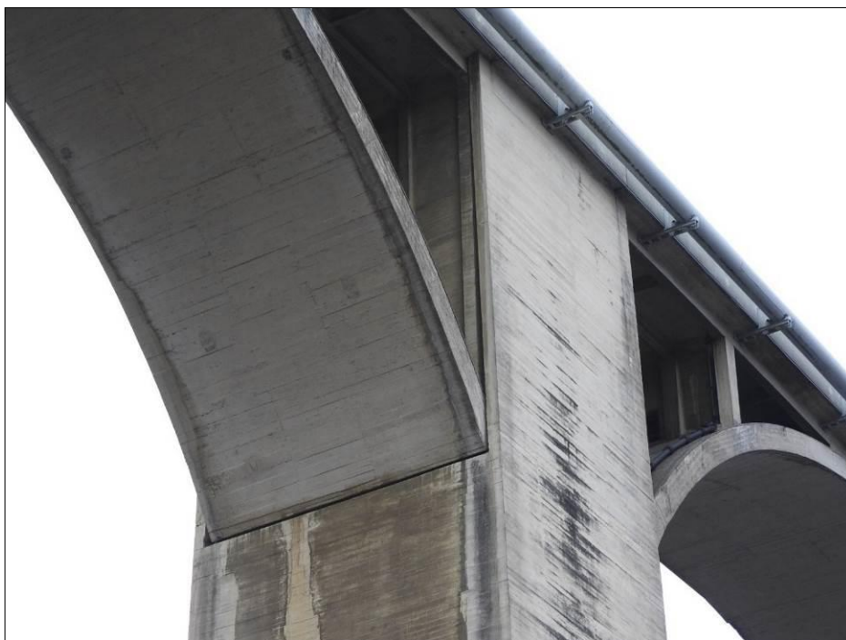
Obr. 35 Posuvné uložení konce mostovky nad patkou oblouku – pružná příčná stěna podpěry je vetknutá do konce mostovky a oddílatovaná svislými spárami od rovnoběžných stěn podpěry; zde dvoukloubový oblouk – v patě oblouku je vodorovná spára betonového kloubu; mostovka je roštová; Podolsko, 1942, L_{max} = 150,000 m
